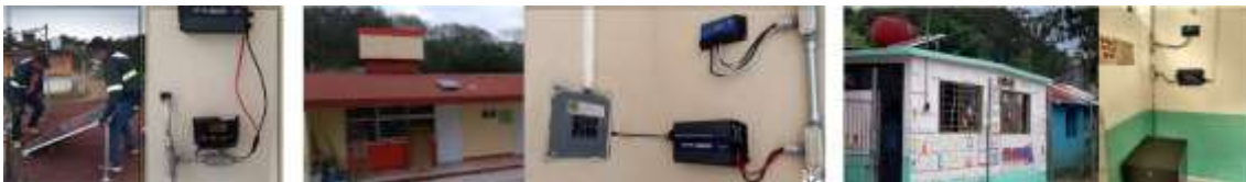
Figura 8 Equipos instalados en los preescolares beneficiados. Fuente propia.
