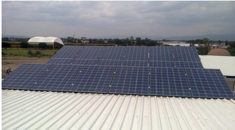
Figura 2. Sistema Fotovoltaico de 4.5kW.
