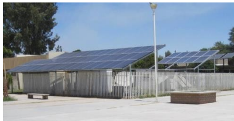
Paneles solares en el ITL, suministrando
